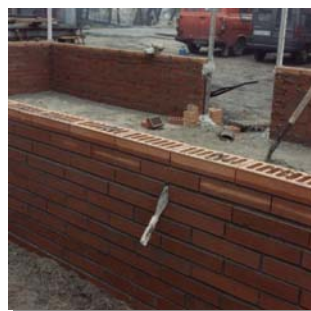
Detalle de las llagas verticales sin mortero.
